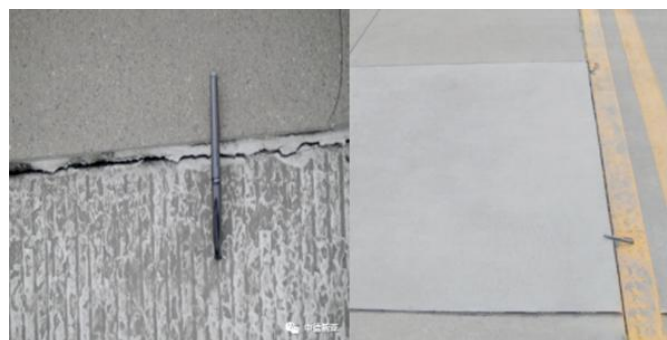
错台、沉陷、坑槽
