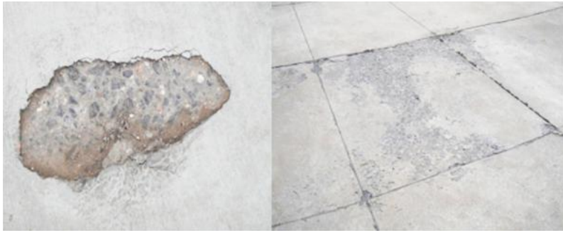
起皮、裂纹、整体板块
