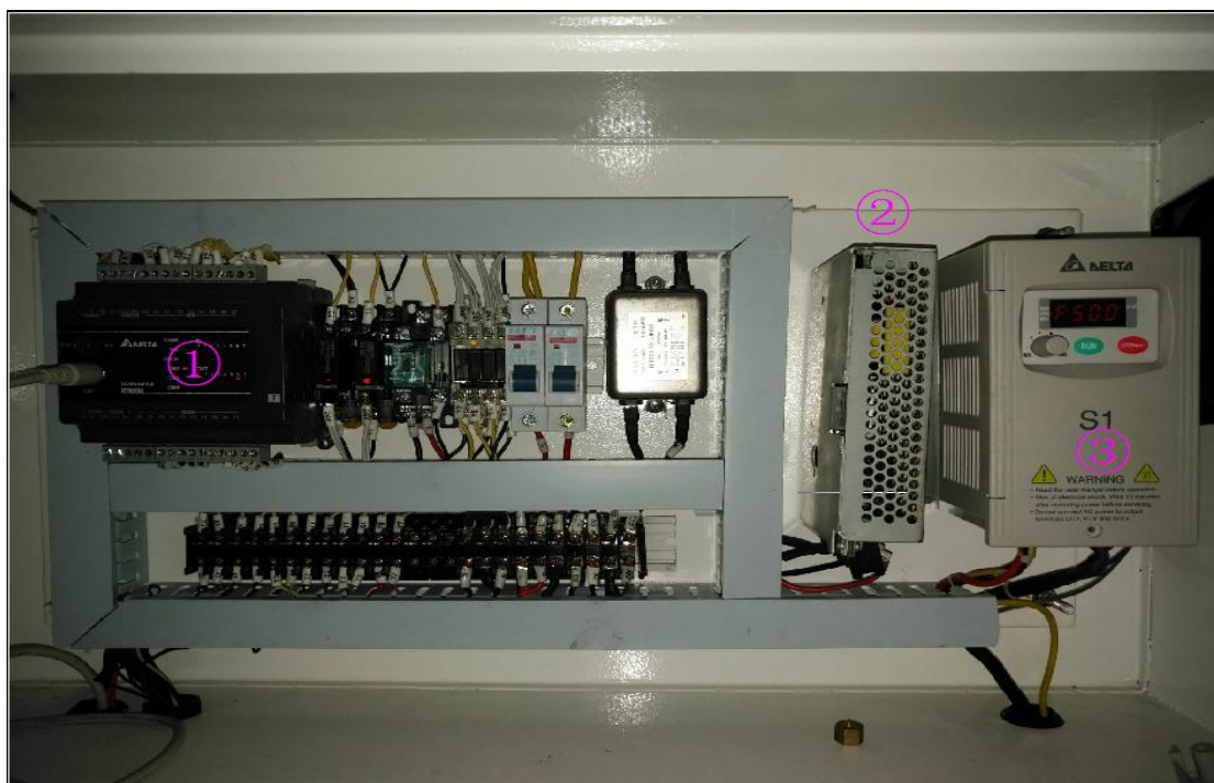
如图：①、PLC 控制器 ②、24V 开关电源 ③、马达变频器
